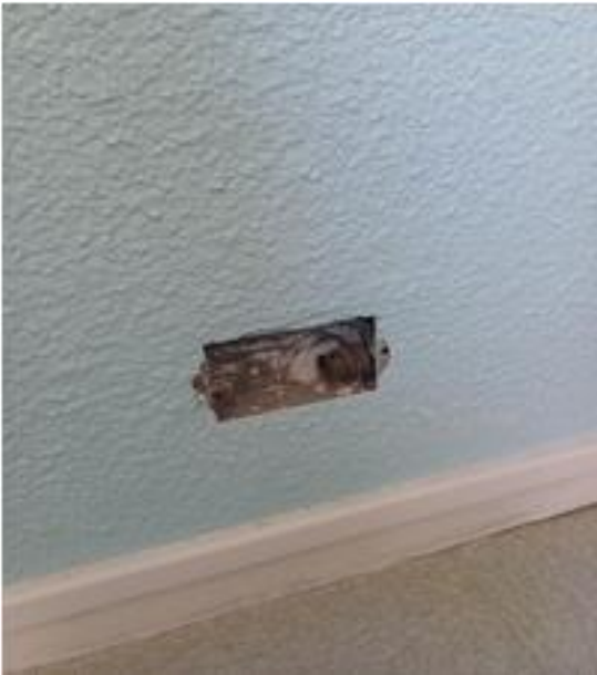
Trou dans le mur
