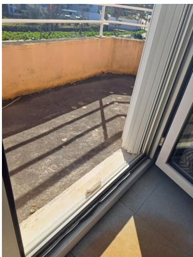
Barre de seuil accès au balcon
