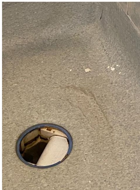
Bonde sans grille – Peinture écaillée au sol – Traces d'évacuation
