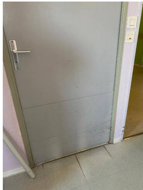
Porte dont la peinture est dégradée
