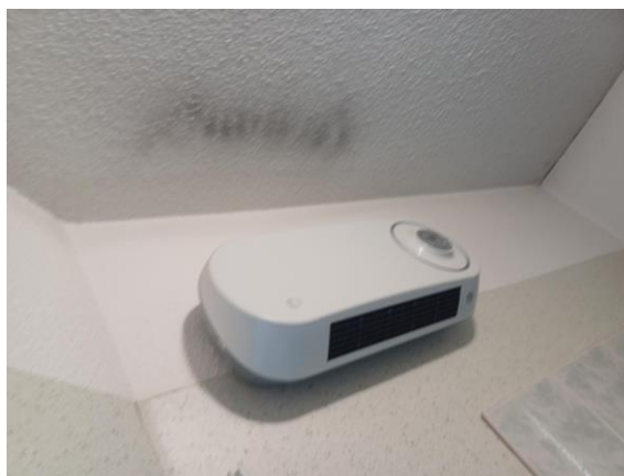
Plafond noirci au dessus d'un système de chauffage dans une salle de bain
